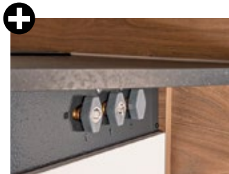
Die Gasabsperrhähne sind vorbildlich platziert und zudem schön verblendet.
