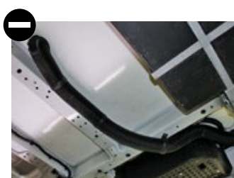
Das Heizungs-Dükerrohr ist isoliert, doch wäre eine Leitung durchs Innere besser.
