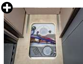
Frisch- und Abwassertank frostsicher und gut zugänglich im Doppelboden.
