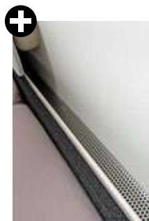
Die Heizungskonvektoren sind mit Lochblechen vor hineinfallenden Gegenständen geschützt.
