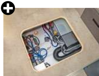
Auch Gas-Warmwasser-Heizung und Frostschutzventil sind gut zugänglich.
