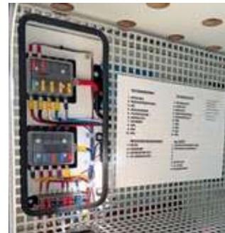
Frostwächter und Standheizung sind gut erreichbar in der Sitztruhe untergebracht.
